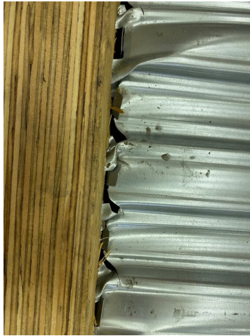
Рис. 11. Смятие стенки в опорном сечении
